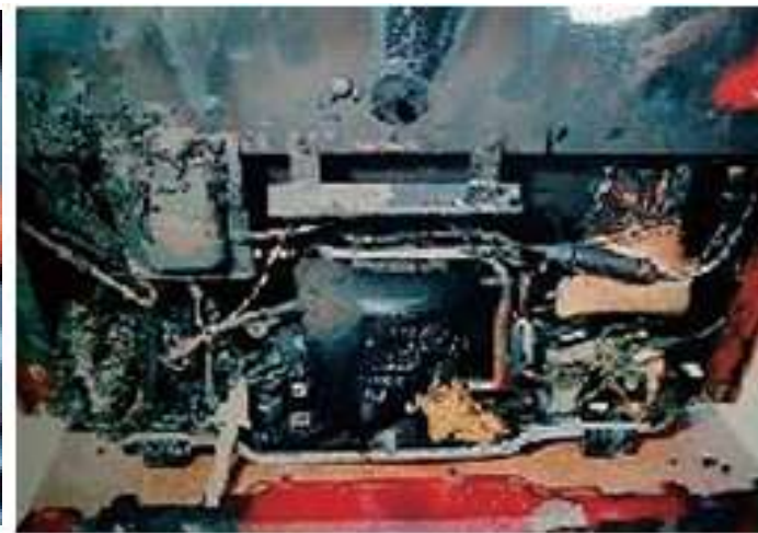
ねずみの尿がかかって発火した 電気機器の基盤部分
